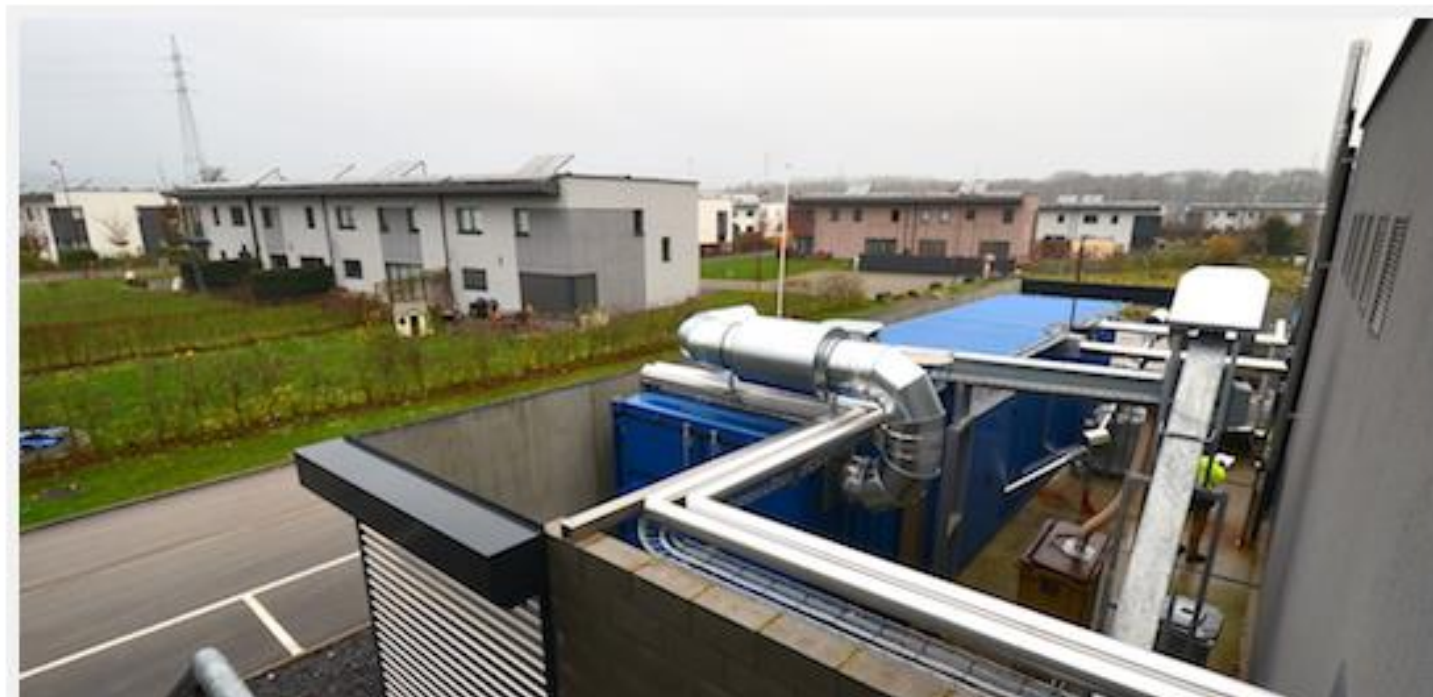
La centrale de micro-cogénération de l'écoquartier de Visé, photo Frédéric Douard
