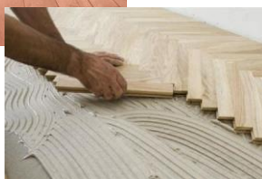
Parquet collé, une des rares solutions biosourcées qui ne fait pas trop perdre l'inertie intérieure du support maçonné
